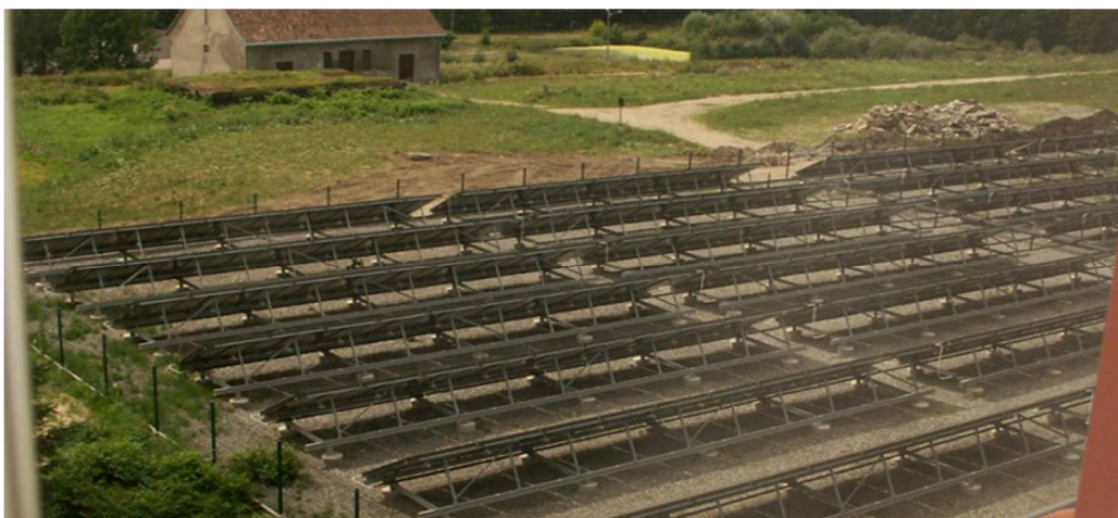
Widok na farmę solarną zainstalowaną w ramach projektu „Poprawa efektywności energetycznej...”
